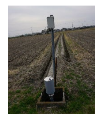
パイプラインが敷かれた 場所に設置している 水田センサーと給水弁*1
